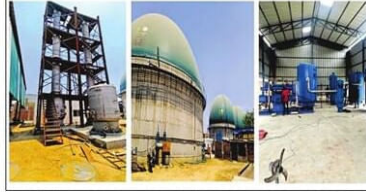
नंगली डेयरी कॉलोनी में बनाया गया दिल्ली का पहला गोबर गैस प्लांट। अमर उजाला
