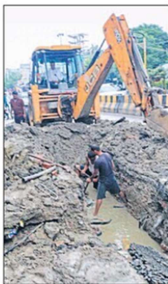
जेलचुंगी के पास गंगाजल की मुख्य पाइपलाइन क्षतिग्रस्त हो गई।
